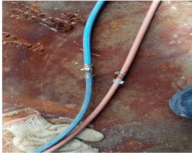
Gambar 2. 16 Clamp omega pada kabel pada selang gas
