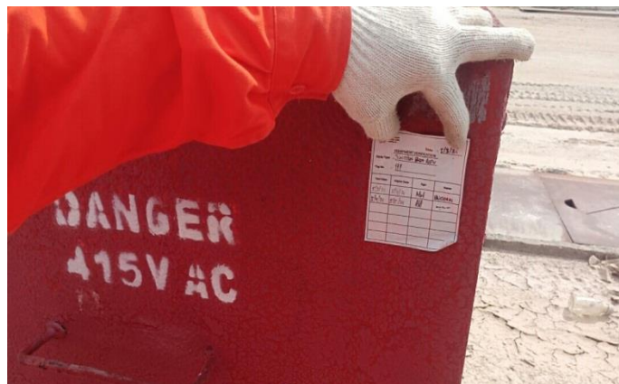
Gambar 2. 17 teks inspeksi pada panel listrik
