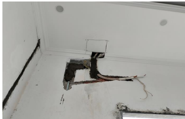
Gambar 3. 52 Tampak lobang bekas pemasangan AC (Sumber: Dokumentasi Kuliah Praktek, 2022)
