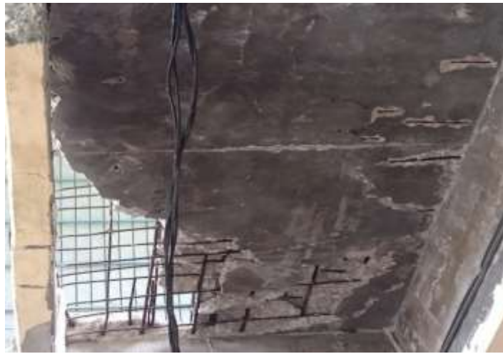
Gambar 1. 3 tulangan pada plat lantai bermunculan (sumber : dokumentasi tugas akhir 2023)
