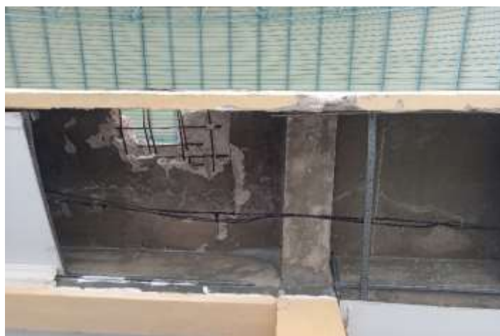
Gambar 1. 2 kerusakan pada plat lantai (sumber : dokumentasi tugas akhir 2023)
