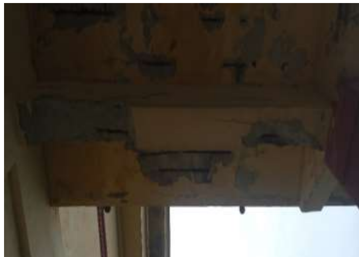
Gambar 1. 4 keretakan pada balok (sumber : dokumentasi proposal TA 2022)
