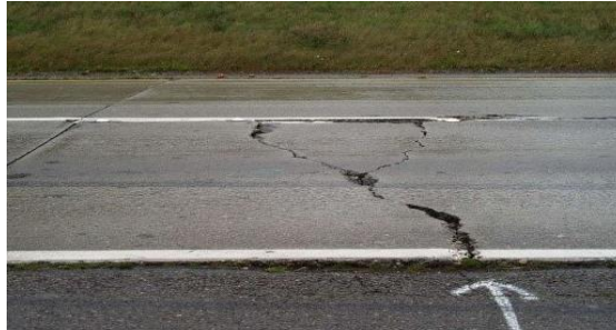
Gambar 2. 7 Retak Sambungan Jalan (Sumber: Bina Marga, 1990)
