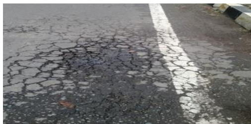
Gambar 2. 2 Retak Kulit Buaya (Sumber: Bina Marga, 1990)
