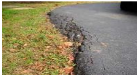
Gambar 2. 5 Retak Pinggir (Sumber: Bina Marga, 1990)
