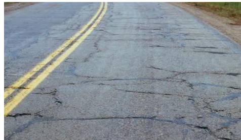
Gambar 2. 9 Retak Refleksi (Sumber: Bina Marga, 1990)
