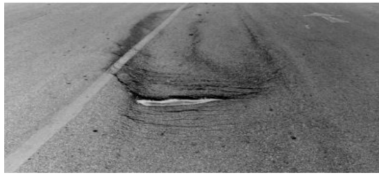
Gambar 2. 3 Retak Slip (Sumber: Bina Marga, 1990)
