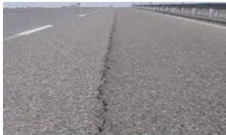
Gambar 2. 4 Retak Memanjang (Sumber: Bina Marga, 1990)
