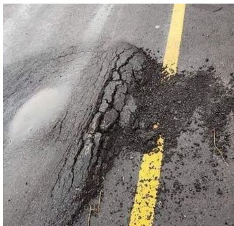
Gambar 2. 21 Kegemukan (Sumber: Bina Marga, 1990)
