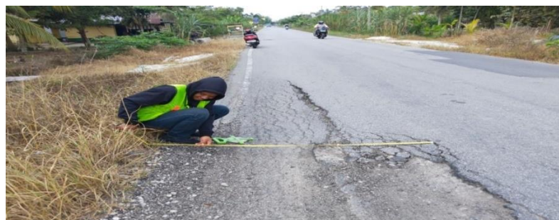
Gambar 4. 2 Survei kerusakan Jalan Sultan Syarif Kasim
