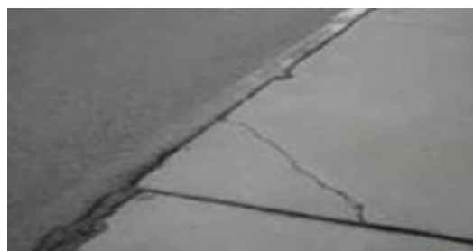
Gambar 2. 6 Retak Sambungan Bahu (Sumber: Bina Marga, 1990)
