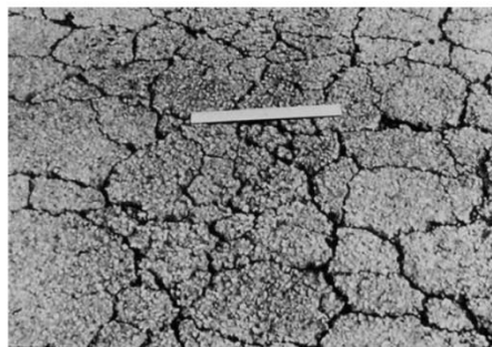
Gambar 2. 2. Retak Kulit Buaya (Alligator Cracking)
