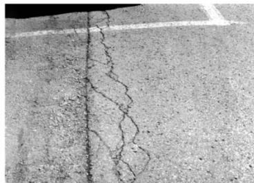
Gambar 2. 4 Retak Retak Pinggir ( Edge Cracking )
