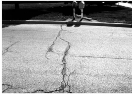
Gambar 2. 3 Retak Kotak-kotak ( Block Cracking )
