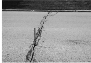
Gambar 2. 6 Retak Memanjang/Melintang ( Longitudinal/Trasverse Cracking )
