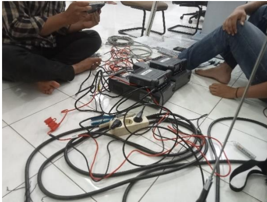
Gambar 3.15. Kabel-kabel Radio Hytera
