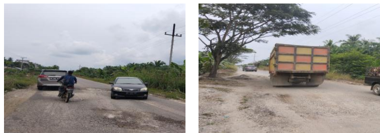
Gambar 1. 1 Kerusakan Jalan Lokasi Penelitian Sumber: Dokumentasi lapangan, 2023
