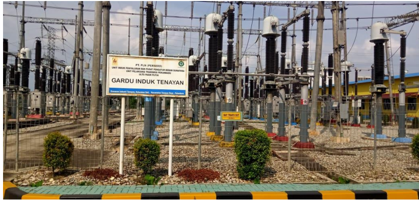
Gambar 1. 2. Gardu Induk PLTU Tenayan (Sumber: Dokumentasi di PLTU TENAYAN)
