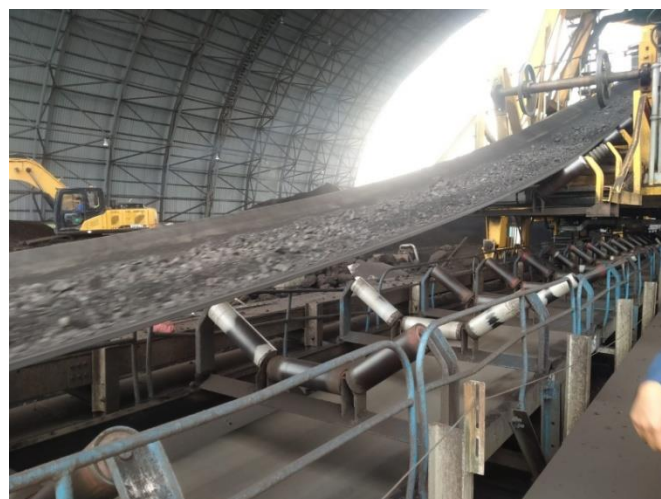
Gambar 2.25. Conveyor C02 (Sumber: Dokumentasi di PLTU TENAYAN)
