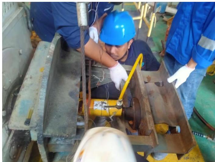
Gambar 2.43. Penanggalan Copling Pada Motor HPFF6 Kv (Sumber: Dokumentasi di PLTU TENAYAN)
