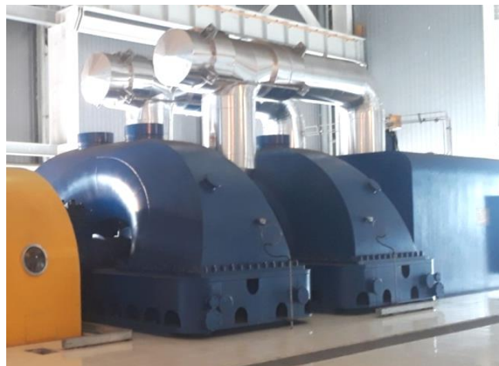
Gambar 2.4 Turbin PLTU Tenayan (Sumber: Dokumentasi di PLTU TENAYAN)
