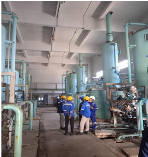
Gambar 2.17. Tanki Filtrasi PLTU Tenaya
