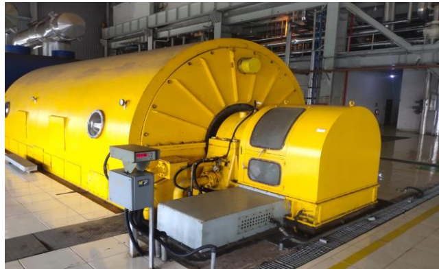
Gambar 2.5 Generator PLTU Tenayan (Sumber: Dokumentasi di PLTU TENAYAN)
