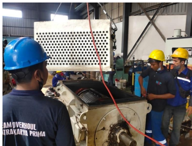
Gambar 2.45. Pelepasan Cooler Pada Motor HPFF 6 Kv
