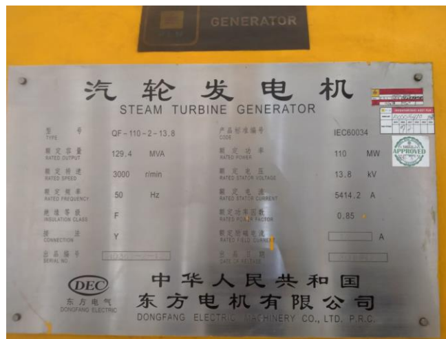
Gambar 2.6 Name Plat Pada Generator PLTU Tenayan (Sumber: Dokumentasi di PLTU TENAYAN)
