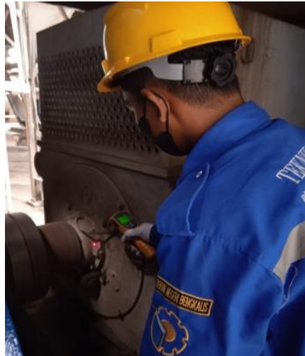
Gambar 3.18. Pemeriksaan Temperatur Bearing (Sumber:Dokumentasi di PLTU TENAYAN)
