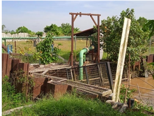
Gambar 2.13. Barscreen (saringan awal ) (Sumber: Dokumentasi di PLTU TENAYAN)
