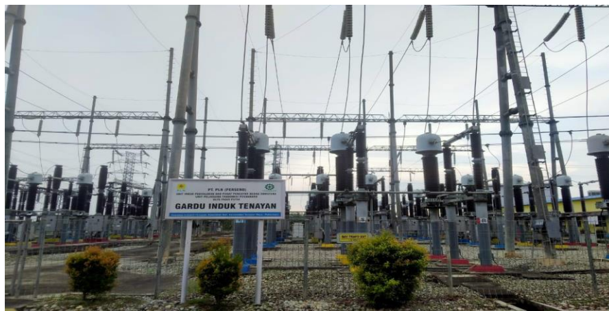
Gambar 2.11. Gardu Induk PT. UBJOM PLTU TENAYAN (Sumber: Dokumentasi di PLTU TENAYAN)
