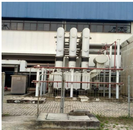
Gambar 2.9 Unit Auxillary Transformator (Sumber: Dokumentasi di PLTU TENAYAN)
