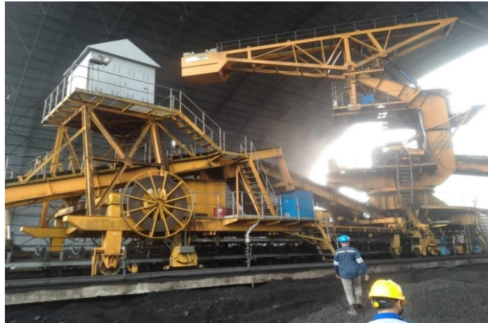
Gambar 2.24. Stacker Reclame PLTU Tenayan (Sumber: Dokumentasi di PLTU TENAYAN)
