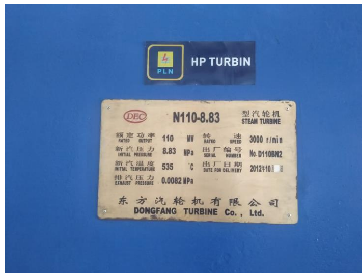
Gambar 2.3 Name Plat Turbin PLTU Tenayan (Sumber: Dokumentasi di PLTU TENAYAN)
