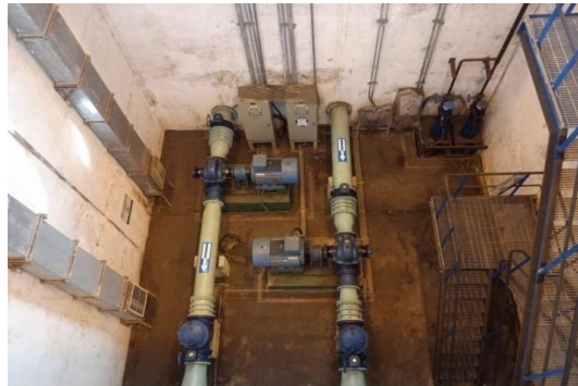
Gambar 2.16. Motor Water Intek Pump (Sumber: Dokumentasi di PLTU TENAYAN)
