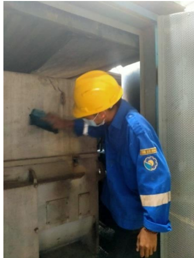
Gambar 2.34. PM Diarea Boiler Motor HPFF 6 kv (Sumber: Dokumentasi di PLTU TENAYAN)
