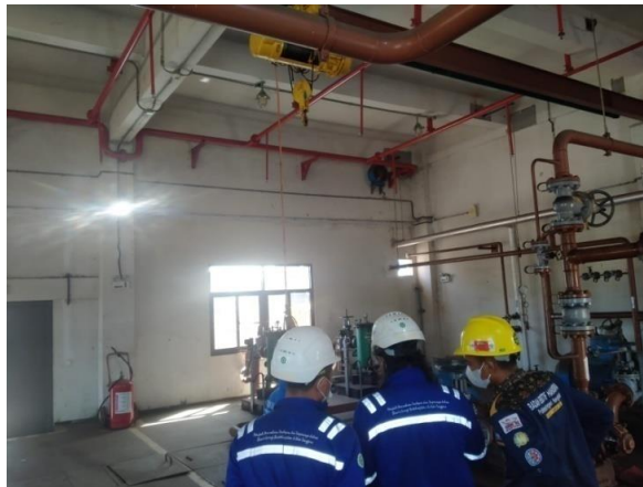
Gambar 2.29. Bagian Dalam Fuel Pump House PLTU TENAYAN
