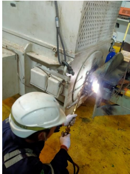
Gambar 2.44. Proses Pemuaian/Pemanasan Pada Copling Motor HPFF 6 Kv
