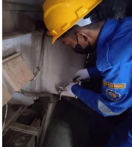
Gambar 3.15. Pengecekan Terminasi Grounding (Sumber:Dokumentasi di PLTU TENAYAN)
