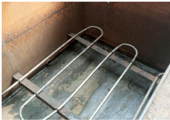
Gambar 3.1. Bak sirkulasi dengan pipa steam di dasar bak (sumber : dokumentasi penulis 2023)
