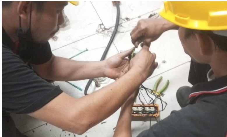
Gambar 2.1. Pemasangan kabel yang terlepas dari terminal (sumber : dokumentasi penulis 2023)
