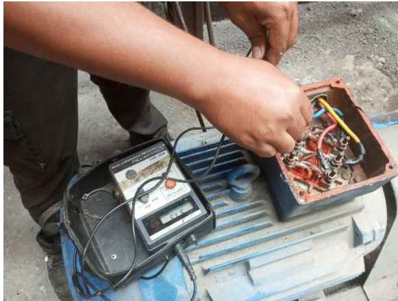
Gambar 2.9. Cek Instalasi Motor Pompa Sirkulasi (sumber : dokumentasi penulis 2023)
