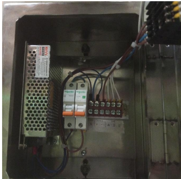
Gambar 2.7. Panel Temperature Control (sumber : dokumentasi penulis 2023)
