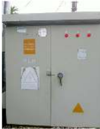
Gambar 3.1 Gardu Disriibusi PHB-TR ( Sumber : PT. Adra gemilang, 2023)
