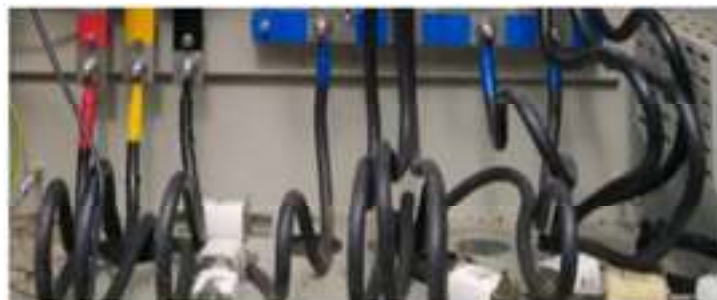
Gambar 3.6 Kabel Opstyg ( Sumber : PT. Adra gemilang, 2023 )
