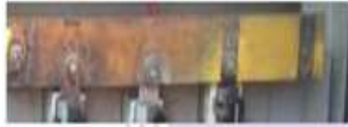
Gambar 3.3 Busbar Atau Saluran Pembagian ( Sumber : PT. Adra gemilang, 2023)
