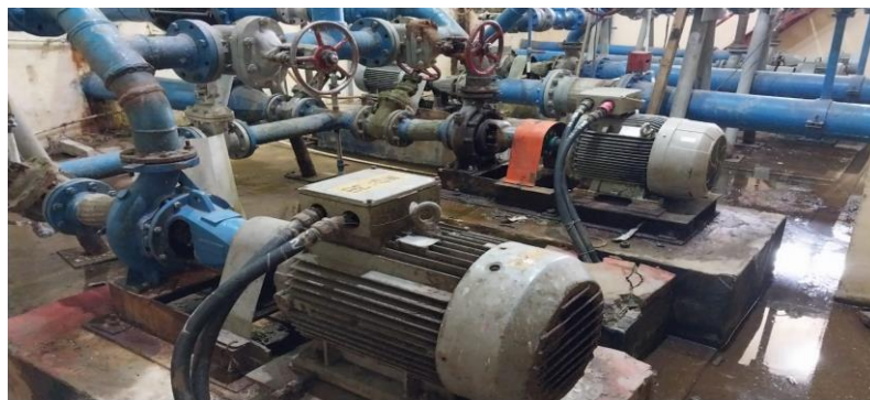
Gambar 3.12 Motor Pompa Air Bersih Dalam Kilang
