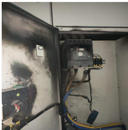
Gambar 2.2 Panel MCCB Terbakar
