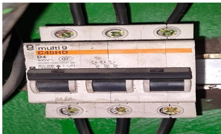
Gambar 4. 3 MCB 3 Phasa (Sumber: Dokumentasi di PT. Indah Kiat Pulp And Paper)
