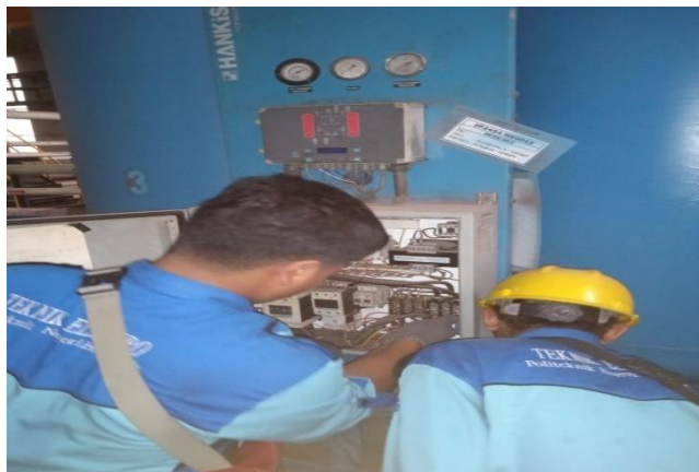
Gambar 2. 39 Gandi Modul Display Compressor PB (Sumber: Dokumentasi di PT. Indah Kiat Pulp & Paper)
