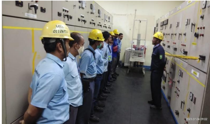
Gambar 3. 2 Stop Powwer MCC (Sumber: Dokumentasi PT. Indah kiat Pulp And paper)
