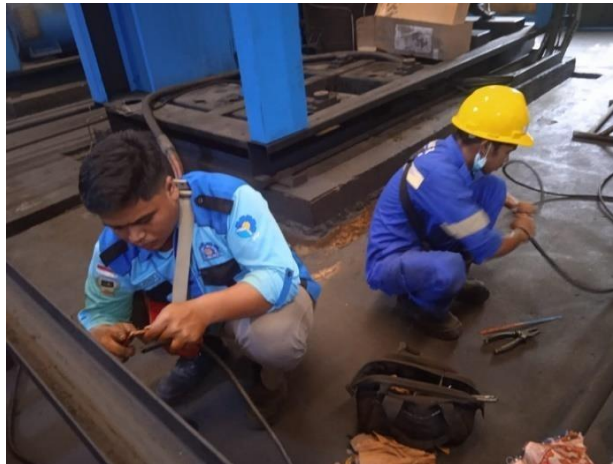
Gambar 2. 30 Tarek Kabel Powwer (Sumber: Dokumentasi di PT. Indah Kiat Pulp and Paper)
