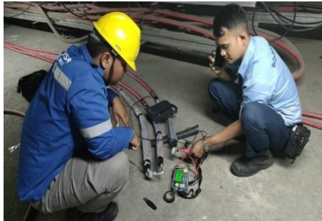
Gambar 2. 6 Magger Kabel 3,3 (Sumber: Dokumentasi di PT. Indah Kiat Pulp and Paper)
