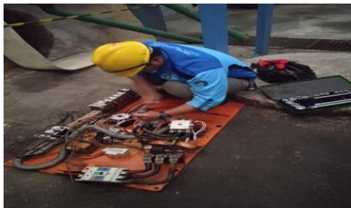
Gambar 2. 48 bongkar isi panel compresor (Sumber: Dokumentasi di PT. Indah Kiat Pulp and Paper)
