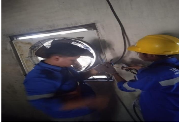
Gambar 2. 36 Pemasangan Fan PB 2 (Sumber: Dokumentasi di PT. Indah Kiat Pulp and Paper)
