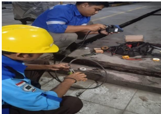
Gambar 2. 41 Pemasangan Auto Drain (Sumber: Dokumentasi di PT. Indah Kiat Pulp and Paper)
