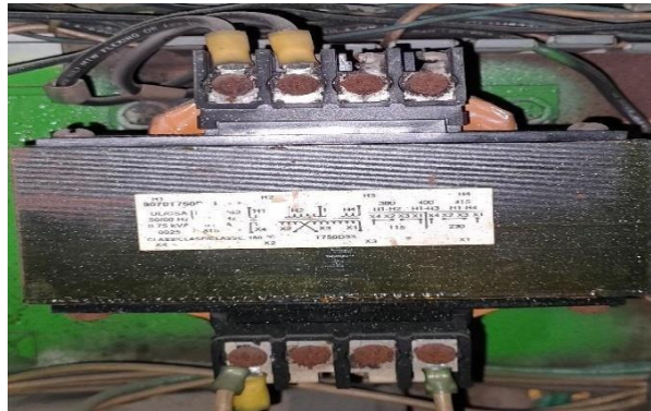
Gambar 4. 2 Trasnformer (Sumber: Dokumentasi di PT. Indah Kiat Pulp And Paper)
