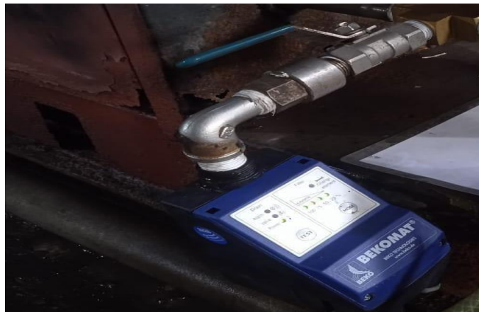
Gambar 3. 1 Pemasangan Auto Drain Otomatis (Sumber: Dokumentasi PT. Indah kiat Pulp and paper)
