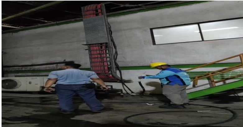
Gambar 2. 4 Penyambungan Dan Tarik Kabel 4cx25Meter± 60Meter (Sumber: Dokumentasi di PT. Indah Kiat Pulp and Paper)
