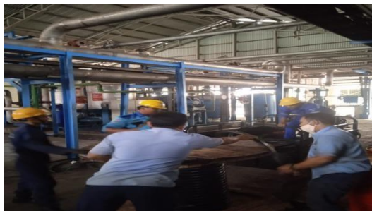
Gambar 2. 14 Penarikan Kabel Power Motor Coling WT 1 (Sumber: Dokumentasi di PT. Indah Kiat Pulp and Paper)
