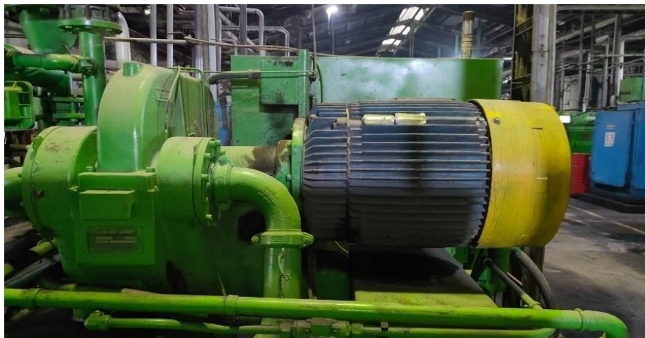
Gambar 4. 6 motor compressor PT. IKPP (Sumber: Dokumentasi di PT. Indah Kiat Pulp And Paper)
