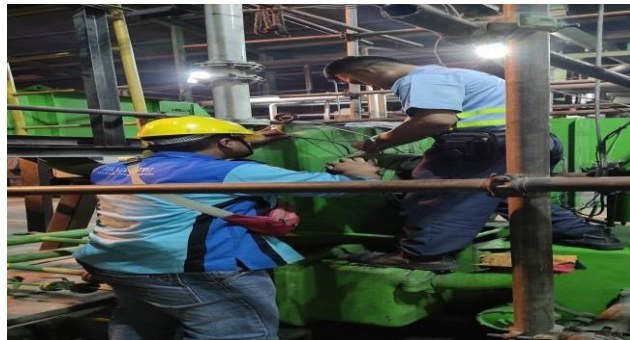
Gambar 2. 10 Membantu Pemasangan Kabel Control Trafo (Sumber: Dokumentasi di PT. Indah Kiat Pulp and Paper)
