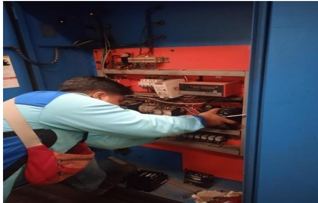
Gambar 2. 38 Gandi Modul Display Compressor PB 3 (Sumber: Dokumentasi di PT. Indah Kiat Pulp & Paper)
