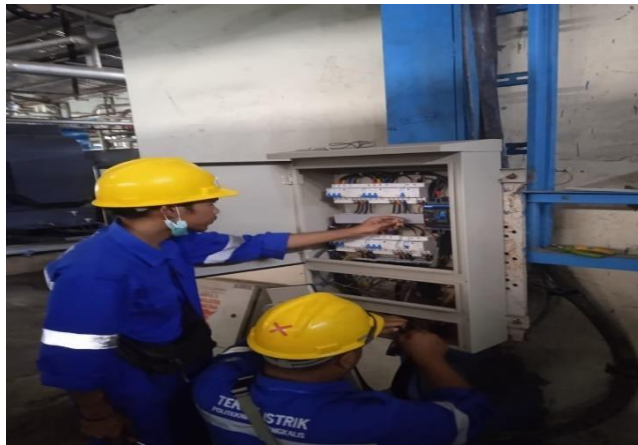
Gambar 2. 32 Pindah Power ELCB (Sumber: Dokumentasi di PT. Indah Kiat Pulp and Paper)
