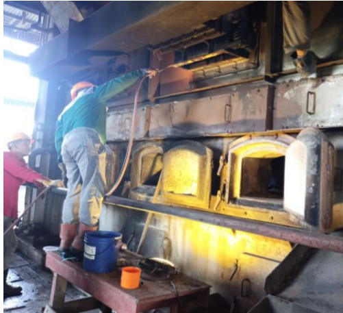
Gambar 3. 4 Preventive Maintenance pada damper spider boiler (Sumber : Dokumentasi penulis)
