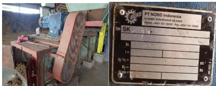
Gambar 4. 3 Motoran pengerak dan gear box scaper conveyor
