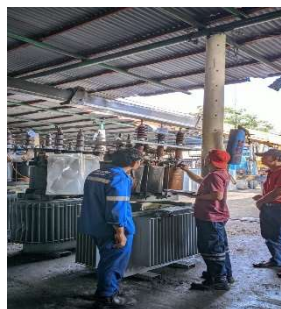
Gambar 2.59 Investigasi Kerusakan Kumparan Trafo (Sumber : Dokumentasi 2023)
