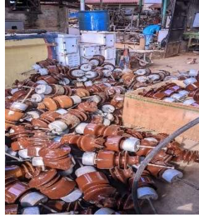
Gambar 2.50 Tumpukan Pin Isolator (Sumber : Dokumentasi 2023)
