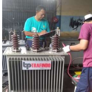
Gambar 4.2 Investigasi Kerusakan Secara Visual (Sumber : Dokumentasi 2023)
