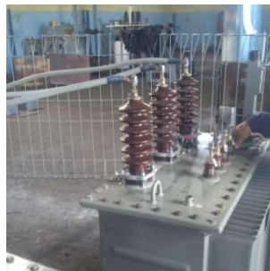
Gambar 4.17 Pengujian Tegangan 20 KV (Sumber : Dokumentasi 2023)
