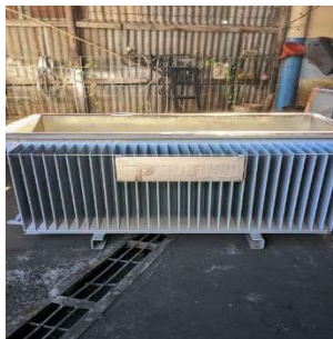
Gambar 3.5 Sirip Radiator Trafo (Sumber : Dokumentasi 2023)
