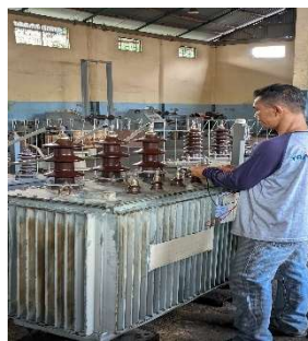
Gambar 2.16 Pengujian Tahap akhir Trafo (Sumber : Dokumentasi 2023)
