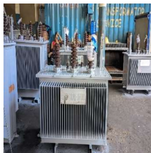
Gambar 4.21 Trafo yang Sudah Selesai Direparasi (Sumber : Dokumentasi 2023)
