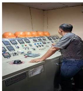
Gambar 2.34 Panel Pengujian Trafo (Sumber : Dokumentasi 2023)
