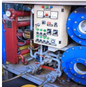
Gambar 4.14 Mesin Flushing Minyak Trafo (Sumber : Dokumentasi 2023)
