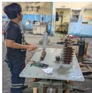
Gambar 4.11 Pengujian Fasa-fasa dan Fasa-netral (Sumber : Dokumentasi 2023)
