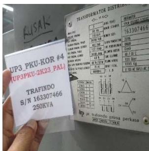
Gambar 3.7 Nameplate Trafo 250 KVA Trafindo (Sumber : Dokumentasi 2023)
