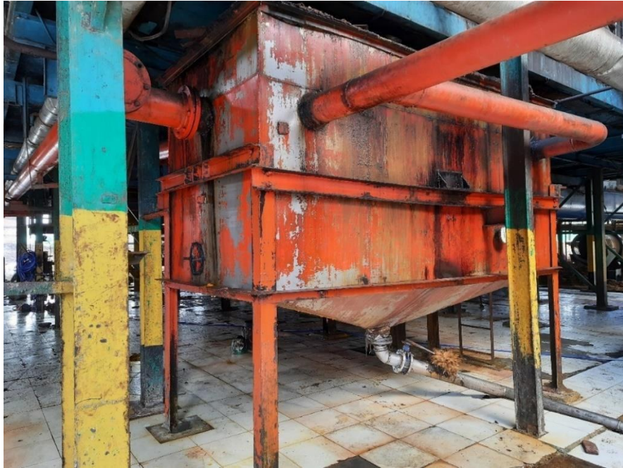
Gambar 2.11 Sand Trap Tank ( Tangki Pemisah Pasir) Sumber: PTPN V KEBUN TANAH PUTIH
