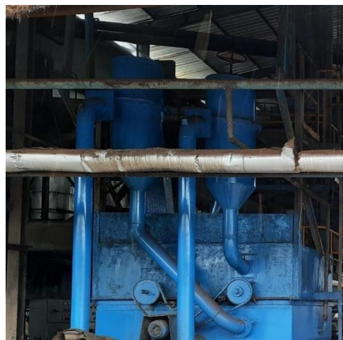
Gambar 2.29 Hydrocyclone Sumber: PTPN V KEBUN TANAH PUTIH
