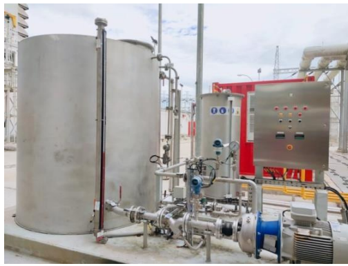
Gambar 4. 4 Tank demin dan tank detergent (Sumber : Dokumentasi pribadi)
