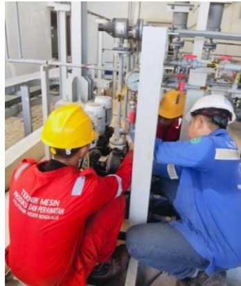
Gambar 3.10 Troubel shooting pompa polymer (Sumber : Dokumentasi pribadi)
