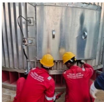
Gambar 3.13 Mainhold HRSG unit 11
