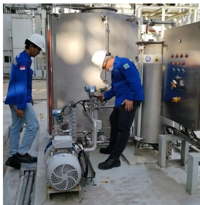
Gambar 4. 6 Membuka katup – katup water wash (Sumber : Dokumentasi pribadi)
