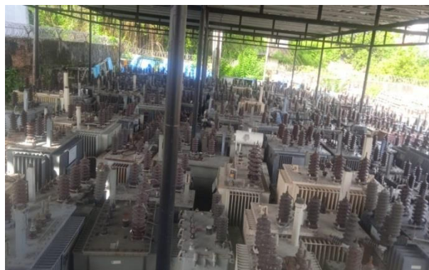
Gambar 2.32. Pemilihan Trafo Rusak (sumber : Dokumentasi 2023)
