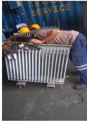
Gambar 2.19. Pembersihan Bodi Trafo
