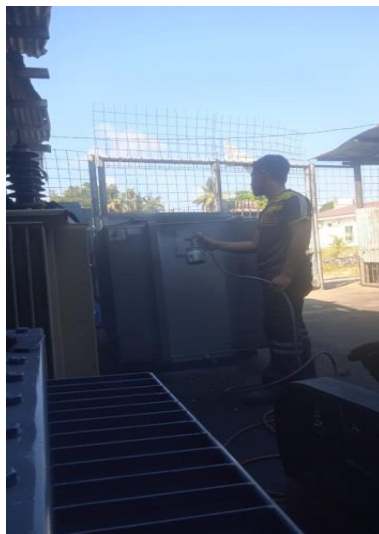
Gambar 2.14. Pengecatan Bodi Trafo (sumber : Dokumentasi 2023)
