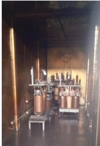
Gambar 2.35. Trafo Dalam Oven (sumber : Dokumentasi 2023)
