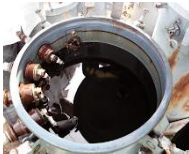
Gambar 3.2. Minyak Trafo (sumber : Dokumentasi 2023)
