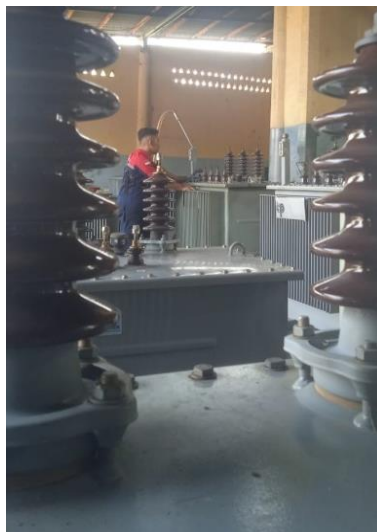
Gambar 2.52. Flushing Minyak Trafo
