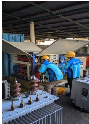
Gambar 2.27. Pemeliharaan Oil Flushing (sumber : Dokumentasi 2023)
