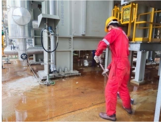
Gambar 3. 6 PM HRSG Unit 11 (Sumber : Dokumentasi Pribadi)
