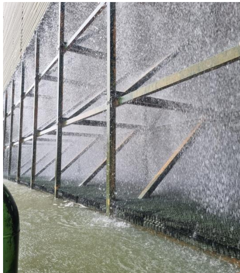
Gambar 4. 8 Rangka Cooling Tower (sumber :dokumentasi pribadi)
