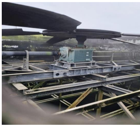
Gambar 4. 9 Kipas Cooling Tower (sumber :dokumentasi pribadi)
