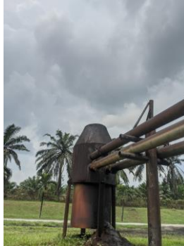
Gambar 4. 13 Proses Pembuangan Exhaust
