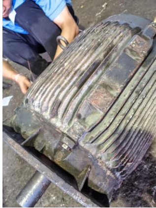
Gambar 2. 47 Mengcouple elmot raw water pump untuk waduk 37 Kw Sumber : Dokumentasi pribadi
