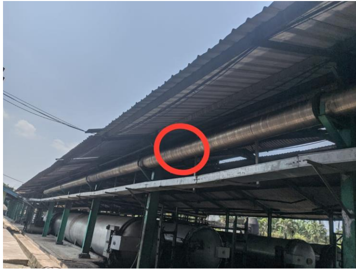
Gambar 4. 11 Menghantarkan Uap Menuju Ketel Rebusan
