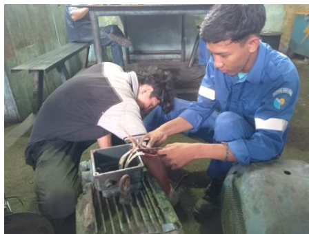
Gambar 2.20 Mengcouple elmot 37 Kw Sumber : Dokumentasi pribadi
