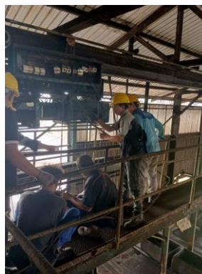
Gambar 2. 66 Mengganti elmot crane naik turun yang terbakar Sumber : Dokumentasi pribadi
