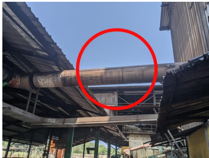
Gambar 4. 10 Menghantarkan Uap Menuju Ketel Rebusan
