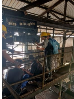
Gambar 2. 43 Mengganti elmot crane naik turun yang terbakar Sumber : Dokumentasi pribadi
