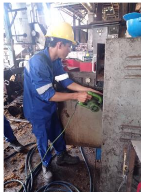
Gambar 2. 14 Mengganti switch terbakar Sumber : Dokumentasi pribadi
