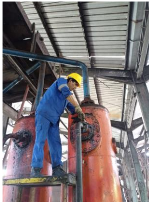
Gambar 2. 28 Mengecek saluran pump drain yang tersumbat Sumber : Dokumentasi pribadi
