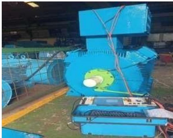
Gambar 2. 9 Pengecekan motor listrik
