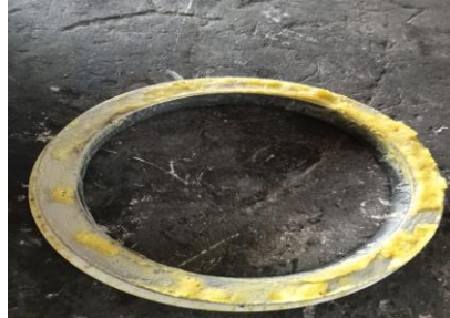
Gambar 4.11 Seat yang rusak (sumber: dokumentasi pribadi)
