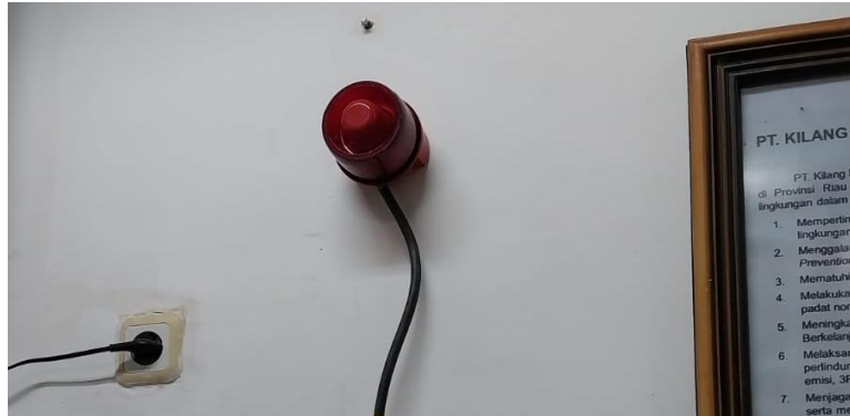
Gambar 3.8 Alarm pada ruang kontrol Pertamina Pakning Sumber : Dokumentasi, 2023
