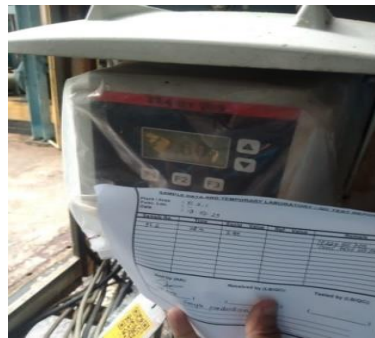
Gambar 2. 21 Value Transmitter FL2 (Sumber : Dokumentasi PT. Indah Kiat pulp & paper Tbk Perawang, 2023)
