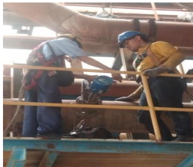
Gambar 2. 13 Pemasangan Sensor Consistency KC 5 (Sumber : Dokumentasi PT. Indah Kiat pulp & paper Tbk Perawang, 2023)
