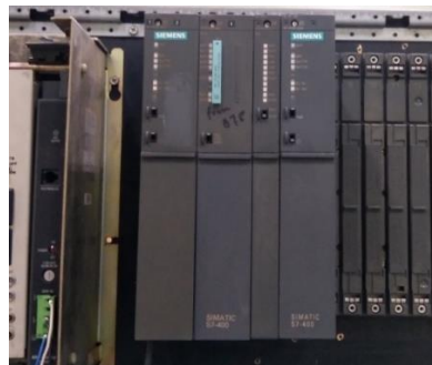
Gambar 2. 9 Bentuk PLC jenis S7-400 (Sumber: PT. Riau Andalan Pulp and Paper )
