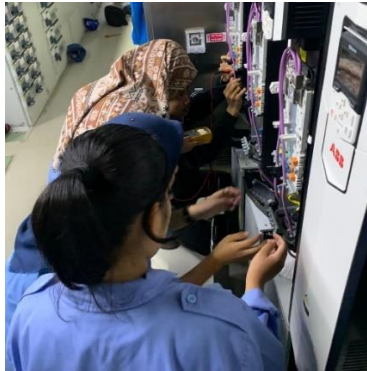
Gambar 3. 17kegiatan cleaning sebagai Preventive Maintenance . (Sumber: PT. Riau Andalan Pulp and Paper).
