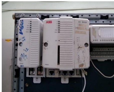
Gambar 2. 8 Bentuk PLC Tipe ABB AC 800M (Sumber: PT. Riau Andalan Pulp and Paper )
