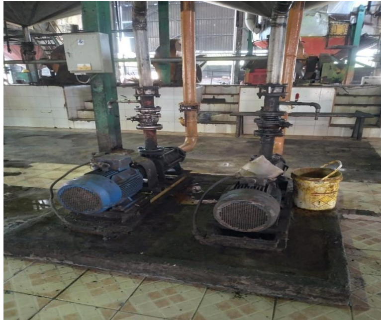
Gambar 3. 11 Pompa Minyak Bersih
