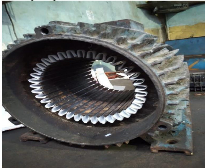
Gambar 2. 71 Memasang Kertas Pressepan Pada Elmot (Sumber: Dokumentasi di PTPN V SEI BUATAN )
