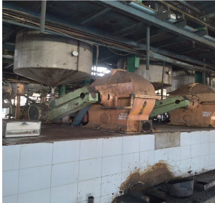
Gambar 3. 16 Sludge Centrifuge (Sumber: Dokumentasi di PTPN V SEI BUATAN )
