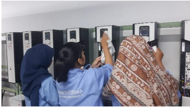
Gambar 3. 21 Cleaning Sebagai Preventive Maintenance (Sumber: Dokumentasi PT. Riau Andalan Pulp and Paper Pangkalan Kerinci, 2023)
