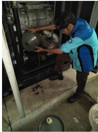
Gambar 2. 47 Menambah oli rutin pada compressor di Power Generator 3
