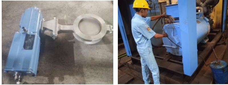
Gambar 2. 20 Valve yang diganti pada air dryer dan memberi greas pada motor compressor .
