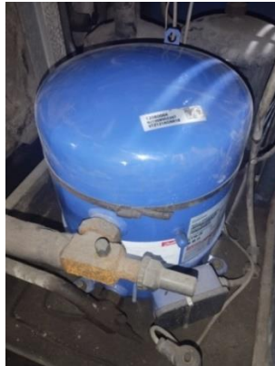
Gambar 4. 10 Motor Compressor pada Air Dryer
