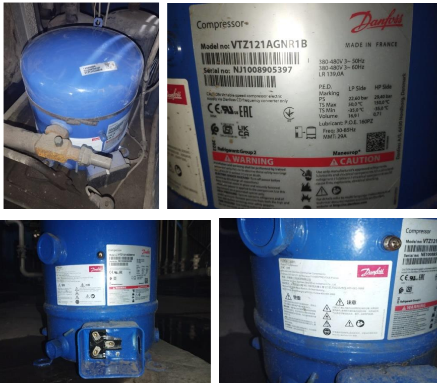
Gambar 4. 29 Motor dan Nameplate pada air dryer di PG 2
