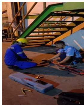
Gambar 2. 3 Terminating dan press skun kabel 3,3 kV, 300 mm untuk kabel power trafo 2000 kVA.
