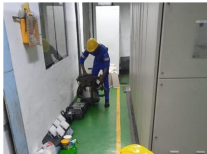
Gambar 2. 21 Melakukan cleaning pada MCC room PG 2 .
