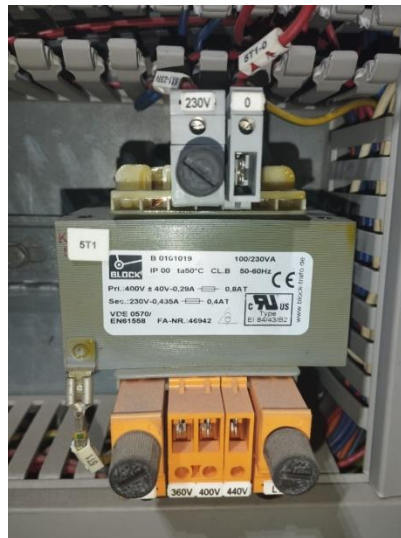
Gambar 4. 15 Trafo pada Air Dryer
