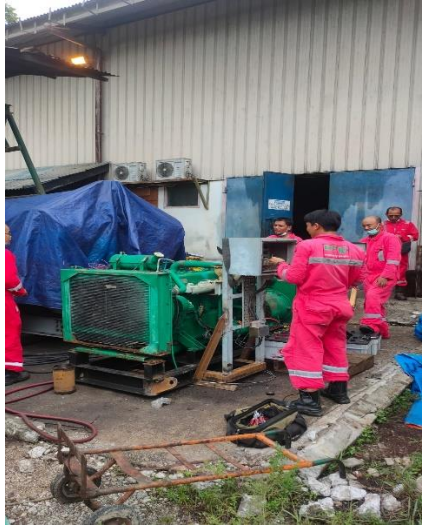
Gambar 2.4 Tes kemampuan genset menggunakan load bank (Sumber : Dokumentasi pribadi 2022)
