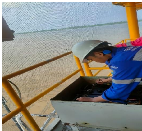
Gambar 2.2 Monitoring kondisi baterai (Sumber : Dokumentasi pribadi 2023)
