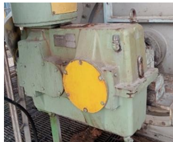
Gambar 4.8 Gearbox Chip Meter Sumber: Dokumentasi Penulis
