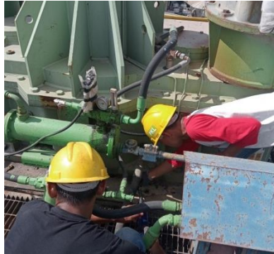
Gambar 4.23 Tambah Grease Pada Critical Gearbox Sumber: Dokumentasi Penulis
