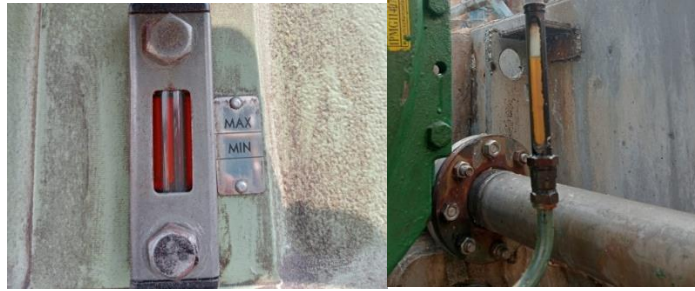
Gambar 4.14 Kondisi Level Oil Sumber: Dokumentasi Penulis
