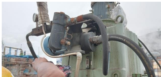
Gambar 4.15 Cek Kondisi Sirkulasi Oil Sumber: Dokumentasi Penulis
