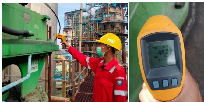
Gambar 4.20. Inspeksi Temperature Critical Gearbox Sumber: Dokumentasi Penulis
