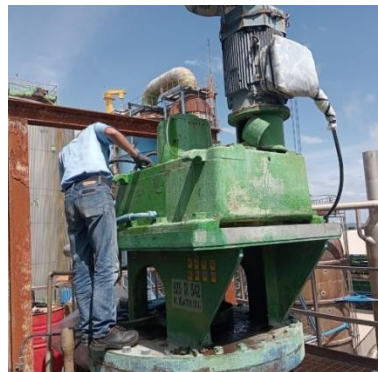
Gambar 4.16 Cek Kebocoran Critical Gearbox Sumber: Dokumentasi Penulis
