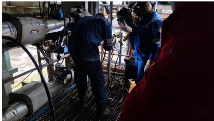
Gambar 3. 5 Pengelasan steam tube yang bocor
