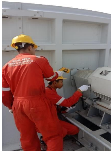
Gambar 3.3 PM di Cooling tower (Sumber : Dokumentasi Pribadi)
