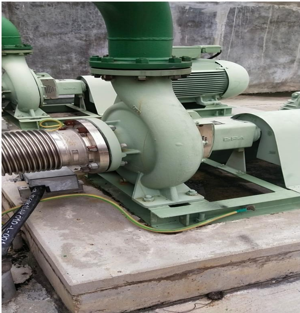
Gambar 4.1 Pompa sentrifugal (sumber: dokumentasi pribadi)
