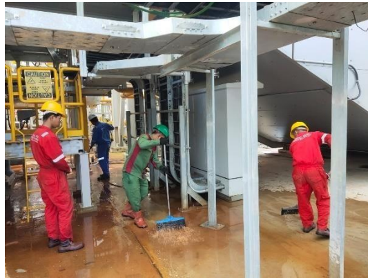
Gambar 3.6 PM HRSG Unit 11 (Sumber : Dokumentasi Pribadi)
