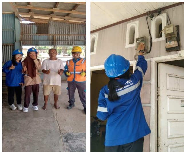
Lampiran 7. Mengganti MCB dan memasukkan kode Clear Tamper (CT)
