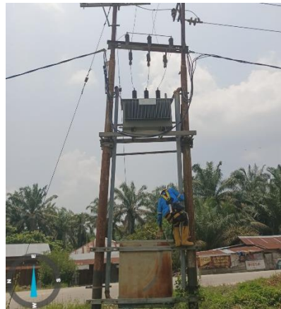
Gambar 4.3.6.a FCO Rusak Atau Trip
