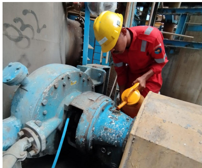
Gambar 4.9 Isi Oil Pompa Sumber dokumentasi sendiri
