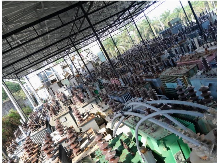
gambar 2. 30 gudang trafo distribusi
