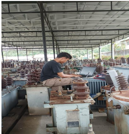
gambar 2. 31 mendata trafo rusak
