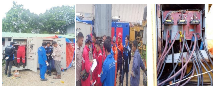
Gambar 3.4 Tes kemampuan genset menggunakan
