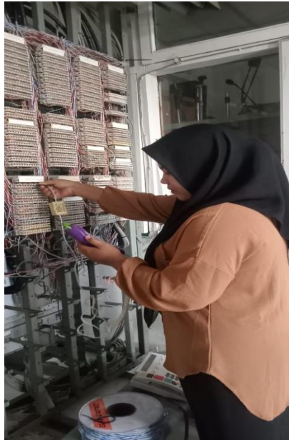
Gambar 3.11 Pengecekan Kabel MDF (Sumber : Dokumen Pribadi)
