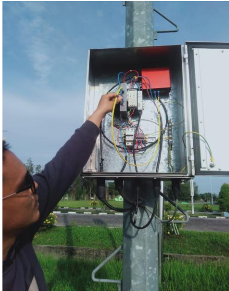
Gambar 3. 8 Pengecekan Jaringan CCTV Sumber : (Dokumen Pribadi)
