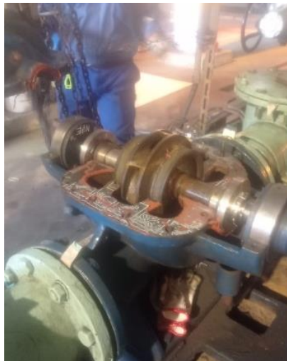
Gambar 2.5 Corrective Maintenance pada Pompa CCCW (Sumber : Dokumentasi Pribadi)
