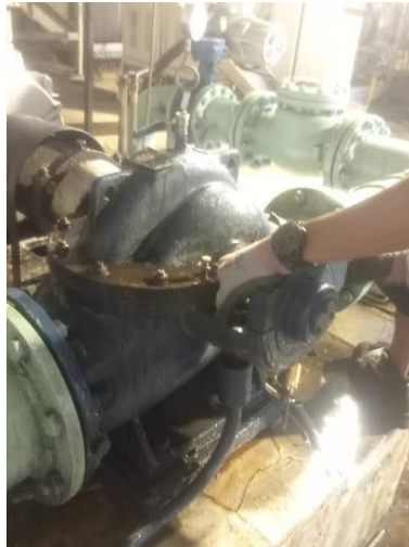
Gambar 2.4 Preventive Maintenance pada Gland Packing Pompa C3WP (Sumber : Dokumentasi Pribadi)
