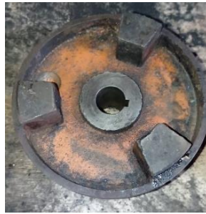
Gambar 4.7 Kopling pompa (Sumber : Dokumentasi sendiri)
