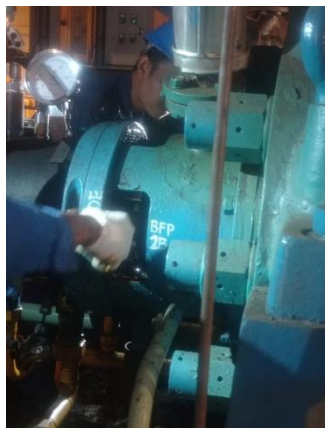
Gambar 3.1 PM di Area Boiler Feed Pumb (Sumber : Dokumentasi Pribadi)
