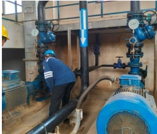
Gambar 3.4 PreventiveMaintenance di Reuse Pump (Sumber : Dokumentasi Pribadi)
