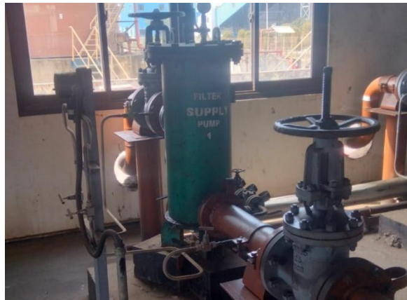
Gambar 3.8 PM di area supply pump (Sumber : Dokumentasi Pribadi)
