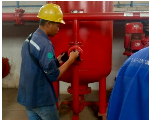
Gambar 3.9 PM di jockey pump (Sumber : Dokumentasi Pribadi)
