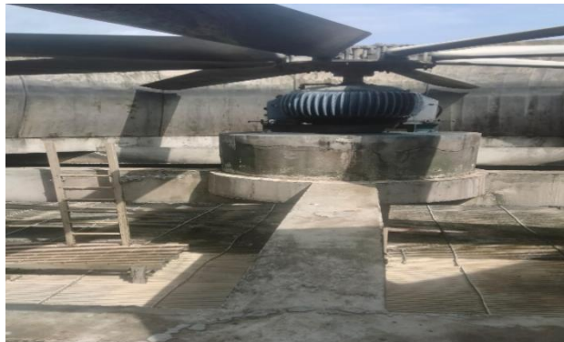
Gambar 3.3 PM di Cooling tower (Sumber : Dokumentasi Pribadi)
