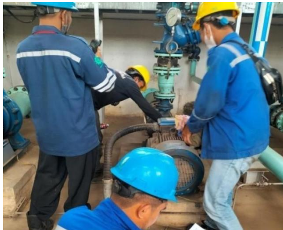
Gambar 3.7 PM di WTP (Sumber : Dokumentasi Pribadi)
