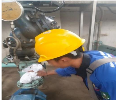
Gambar 2.4 Preventive Maintenance pada industrial water pump (Sumber : Dokumentasi Pribadi)
