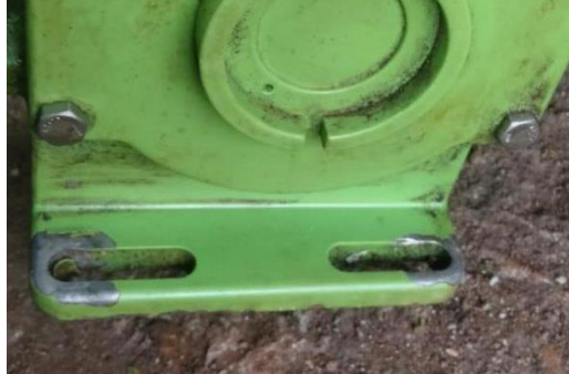
Gambar 4.8 kaki pompa (dokumentasi pribadi)
