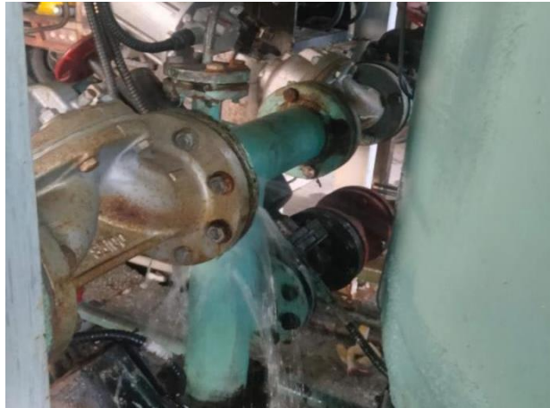
Gambar 3.13 valve pada head exchanger (Sumber : Dokumentasi Pribadi)
