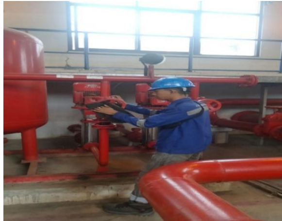
Gambar 3.2 PM di jockey pump (Sumber : Dokumentasi Pribadi)
