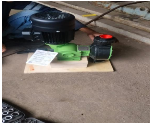
Gambar 4.2 pompa injeksi kimia (sumber dokumentasi pribadi)
