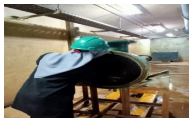
Gambar 2.58 Heat Exchanger 1, unit 2 dan unit 3
