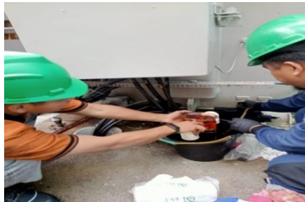
Gambar 2.47 Pengujian kualitas minyak trafo unit 3
