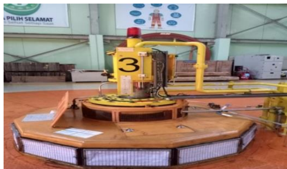
Gambar 3.5 Generator ULPLTA Koto Panjang
