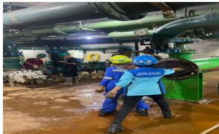
Gambar 2.27 Heat Exchanger 1 dan unit 3
