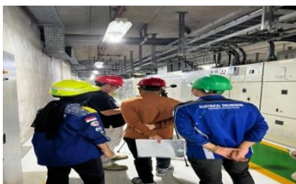
Gambar 2.34 Pemeliharaan lingkungan kerja di area Switchgear
