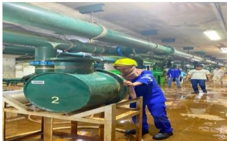
Gambar 2.18 Heat Exchanger 2 dan unit 3
