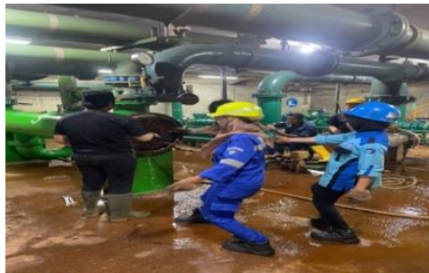
Gambar 2.21 Heat Exchanger 2 dan unit 3
