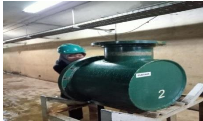
Gambar 2.50 Heat Exchanger 2 dan unit 3
