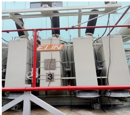
Gambar 3.10 Transformator ULPLTA Koto Panjang unit 3
