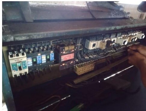
Gambar 2.1 Pengecekan Rangkaian Kontaktor Hoisting crane (sumber : dokumentasi penulis 2023)
