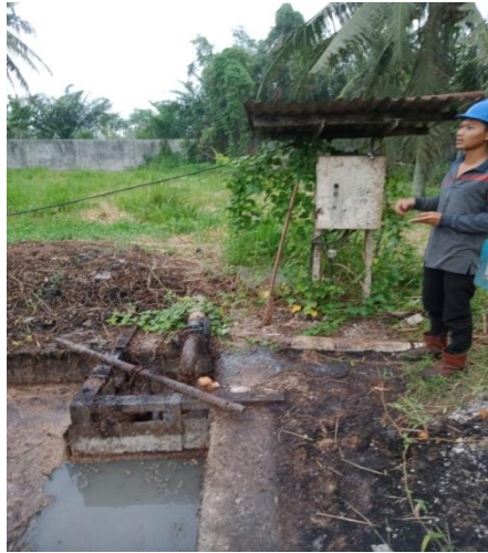
Gambar 2.8 Pengecekan Pompa Sedimentasi
