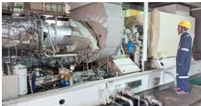
Gambar 3.1 Bentuk Generator (GTG) 900-GE-06
