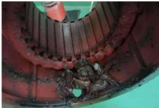
Gambar 3.9 Kondisi Stator exciter Sebelum Dibersihkan
