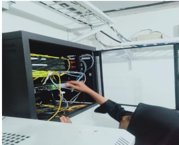
Gambar 3. 6 Pengecekan Distributor Switch (Sumber: Dokumen Pribadi 2023)
