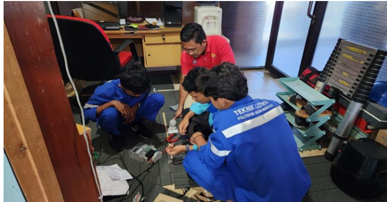
Gambar 16 - Aktivasi KWH 1 Phase Sumber: Dokumentasi di PT PLN Dumai
