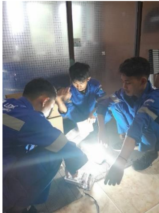
Gambar 19 - Aktivasi KWH Meter 1 Phase Sumber: Dokumentasi di PT PLN Dumai
