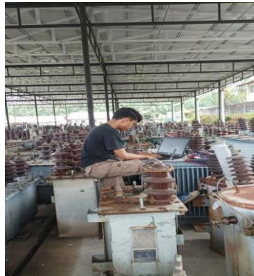
Gambar 33 - Mendata Trafo Rusak Sumber: Dokumentasi di PT PLN Dumai
