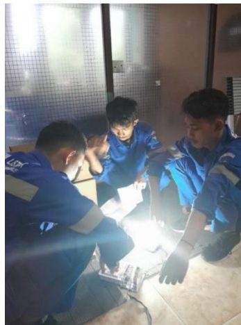
Gambar 29 - Aktivasi KWH Meter 1 Phase Sumber: Dokumentasi di PT PLN Dumai
