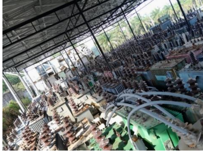
Gambar 32 - Gudang Trafo Distribusi Sumber: Dokumentasi di PT PLN Dumai
