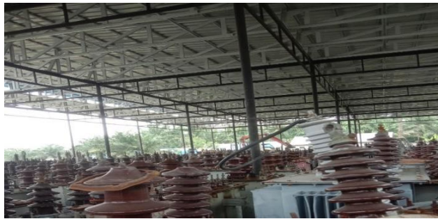
Gambar 36 - Mendata Trafo Sumber: Dokumentasi di PT PLN Dumai
