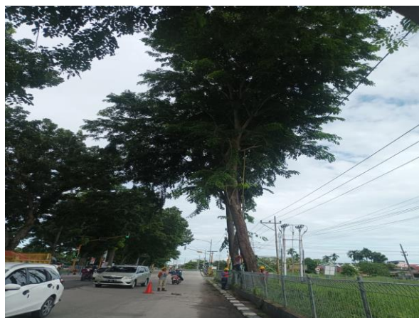
Gambar 15 – HAR Sumber: Dokumentasi di PT PLN Dumai
