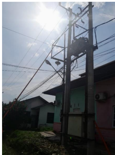
Gambar 22 - Trafo Distribusi Sumber: Dokumentasi di PT PLN Dumai
