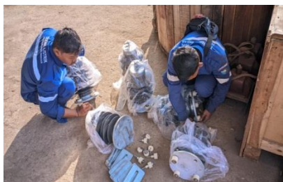
Gambar 2.8 Perangkaian arester (Sumber : dokumentasi 2023)
