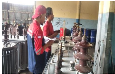
Gambar 2.60 Pengujian trafo (Sumber : dokumentasi 2023)
