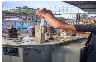
Gambar 2.31 Pengecekan minyak trafo (Sumber : dokumentasi 2023)
