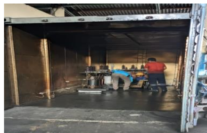
Gambar 2.29 Masukan trafo ke ofen (Sumber : dokumentasi 2023)
