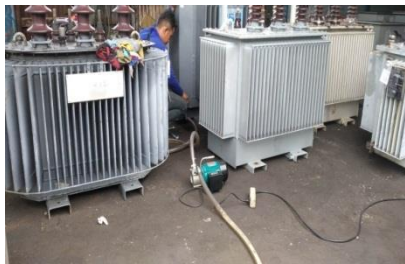
Gambar 2.36 Pengecekan minyak pada trafo (Sumber : dokumentasi 2023)
