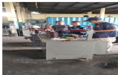
Gambar 2.23 Pengukuran trafo (Sumber : dokumentasi 2023)
