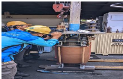
Gambar 2.15 Penguncian Baut Trafo (Sumber : dokumentasi 2023)
