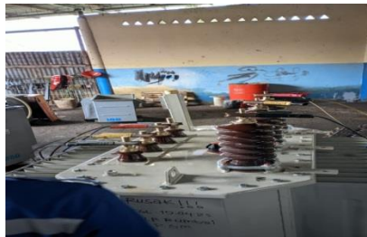
Gambar 2.34 Pengujian trafo (Sumber : dokumentasi 2023)
