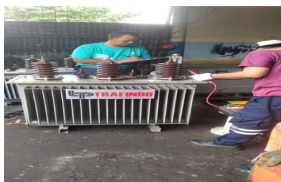
Gambar 2.3 Pengukuran trafo (Sumber : dokumentasi 2023)
