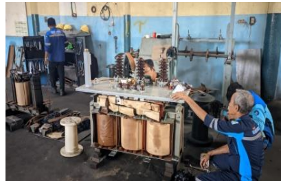
Gambar 2.28 Jointing trafo (Sumber : dokumentasi 2023)
