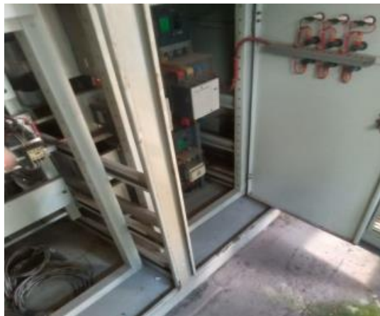
Gambar 2.27 Pengecekan Kapasitor Panel Sumber: (Dokumentasi, 2023)
