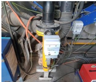
Gambar 2.4 Pengecekan Servo Motor Boiler Advant Sumber: (Dokumentasi, 2023)
