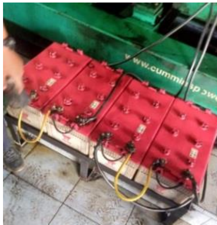
Gambar 2.39 Pengecekan Batre Genset. Sumber: (Dokumentasi, 2023)
