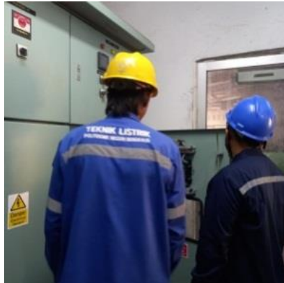
Gambar 2.7 Pengenalan Panel Genset Sumber: (Dokumentasi, 2023)
