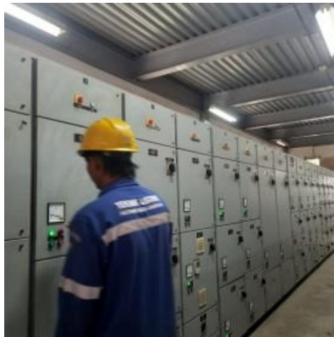
Gambar 2.15 Pengecek Panel di MCC Sumber: (Dokumentasi, 2023)
