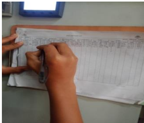
Gambar 2.59 Pengambilan Data Metering di Panel Sumber: (Dokumentasi, 2023)
