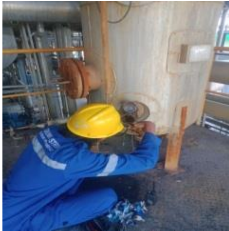
Gambar 2.41 Pengecekan Transmitter Sumber: (Dokumentasi, 2023)
