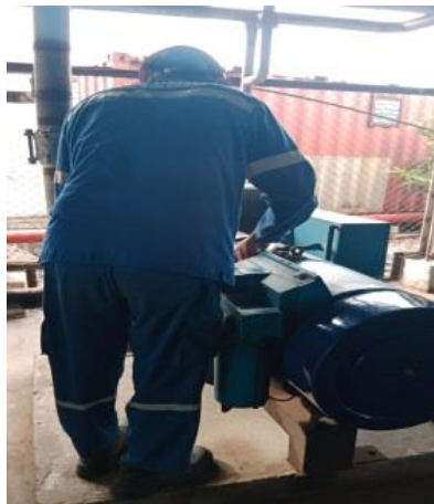
Gambar 2.22 Cleaning Compressor Sumber: (Dokumentasi, 2023)
