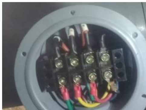
Gambar 2.25 Connect Motor Chiler di Refinery Sumber: (Dokumentasi, 2023)
