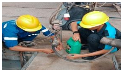
Gambar 2.45 Mengisi Oli Pompa di Refinery Sumber: (Dokumentasi, 2023)
