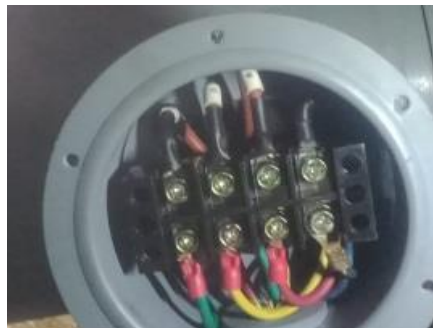
Gambar 2.44 Connect Kabel Motor Chiler Sumber: (Dokumentasi, 2023)
