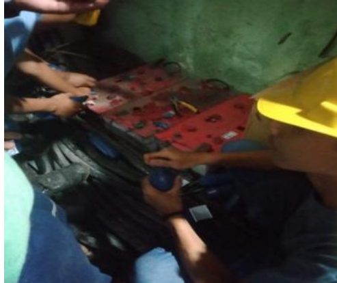
Gambar 2.38 Mengisi Air Batre Genset Sumber: (Dokumentasi, 2023)
