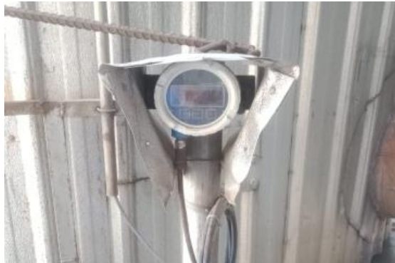
Gambar 2.24 Pengecekan Transmitter Level Sumber: (Dokumentasi, 2023)
