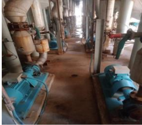
Gambar 2.31 Cleaning Area Aktuator Sumber: (Dokumentasi, 2023)
