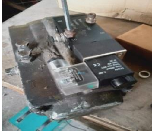
Gambar 2.26 Pengecekan Aktuator Valve Sumber: (Dokumentasi, 2023)
