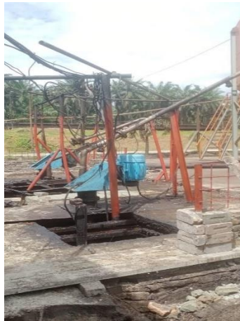
Gambar 2. 46 Perawatan pada elmots pompa transfet fat fit
