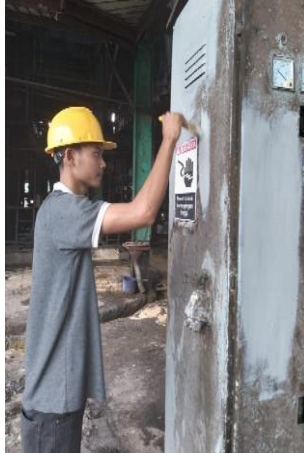
Gambar 2. 25 Perawatan pada panel
