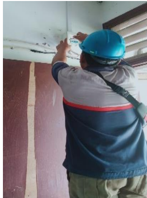
Gambar 2. 3 Mengganti mcb 1 phasa yang terbakar
